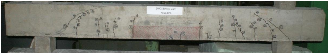
Рис. 3.42. Тріщини у зразку ЗБП4
