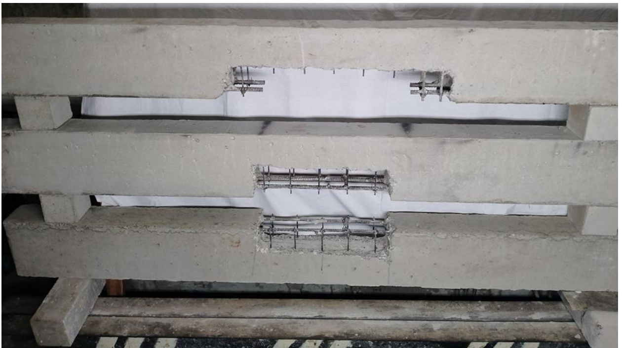
Рис. 2.10. Пошкодження балок у стиснутій та розтягнутій зонах
