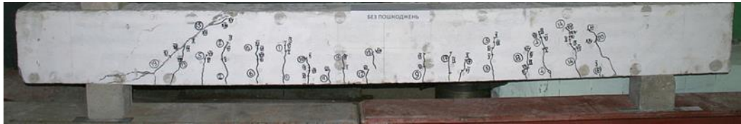
Рис. 3.38. Тріщини у непошкодженій балці
