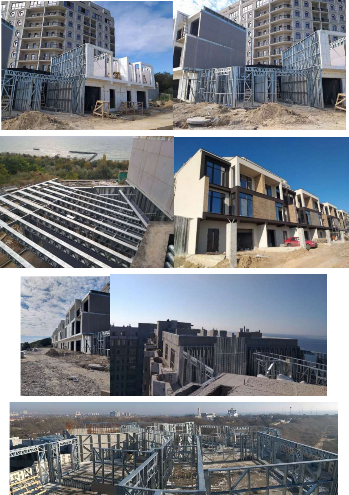
Рис. 5.16 – Фотофіксація застосування розроблених та запатентованих рішень в умовах будівельного виробництва на різних об'єктах
