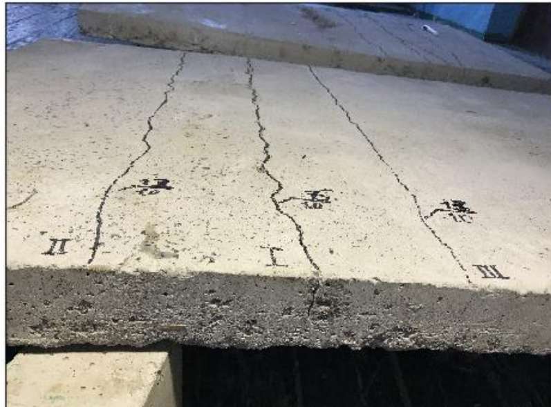
Рис. 2.29. Ширина розкриття тріщин у залізобетонній плиті на консолі
