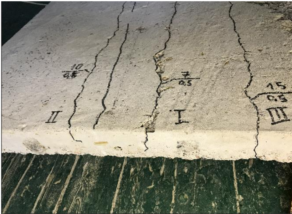
Рис. 2.37. Ширина розкриття тріщин у фібробетонній плиті на консолі
