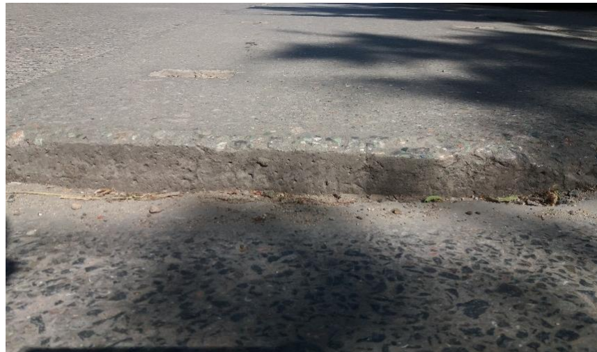
Рис. 1.15 Вертикальне переміщення сусідніх плит
