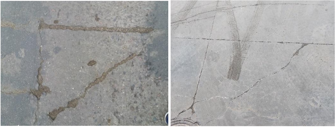
Рис. 1.11 Відкол куту плити
