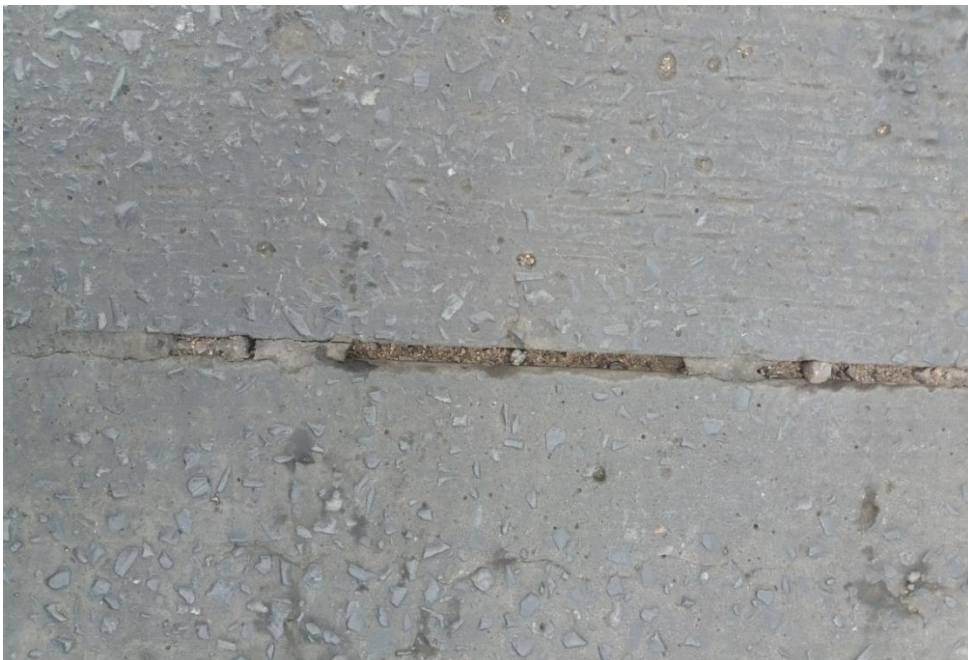
Рис. 1.13 Часткове руйнування заповнювача шва
