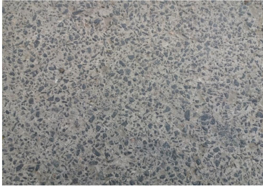
Рис. 1.8 Стирання покриття з оголюванням крупного заповнювача
