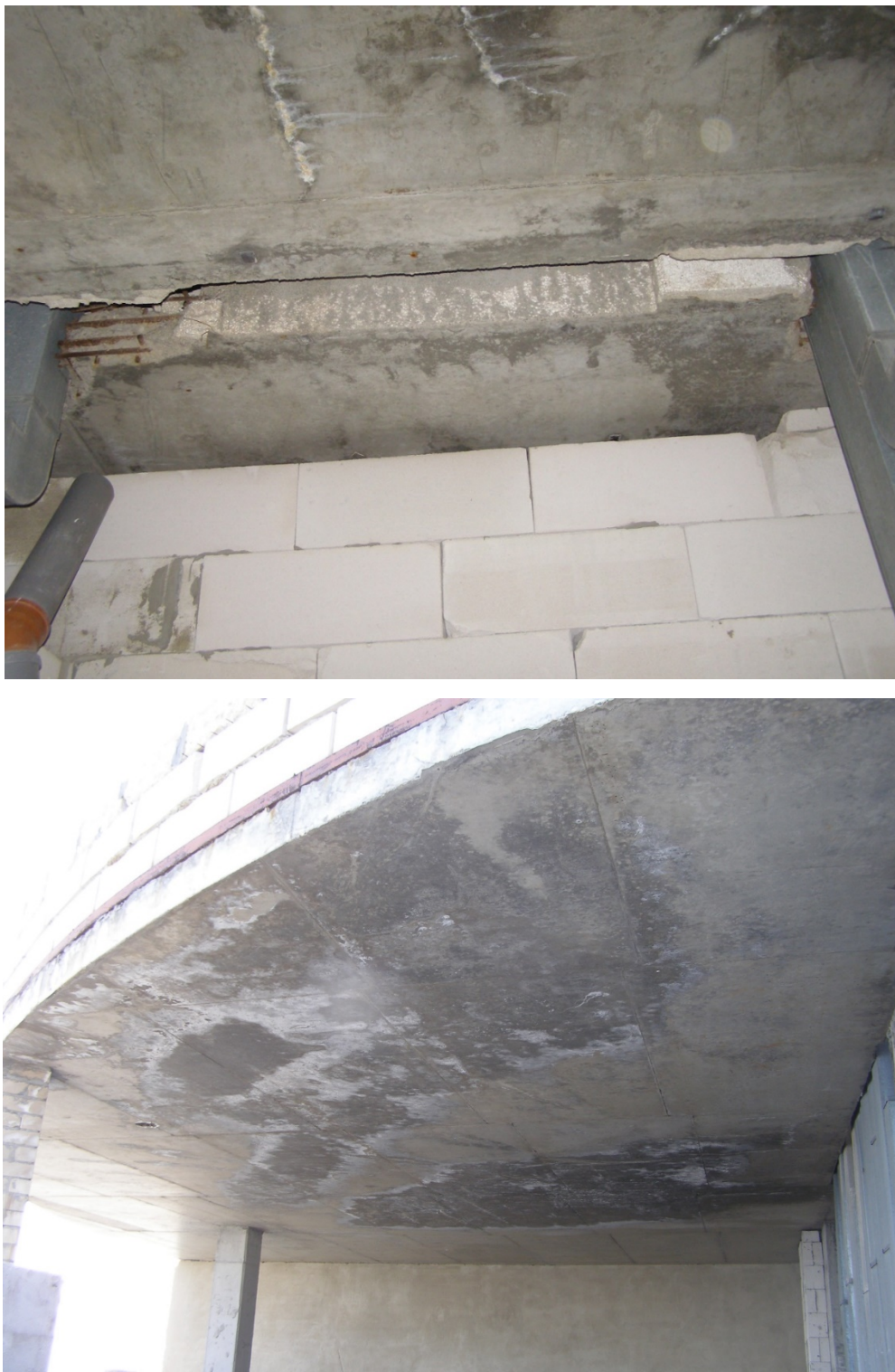
Рис. 4.3. Фотофіксація тріщин плити на позначці +69.300
