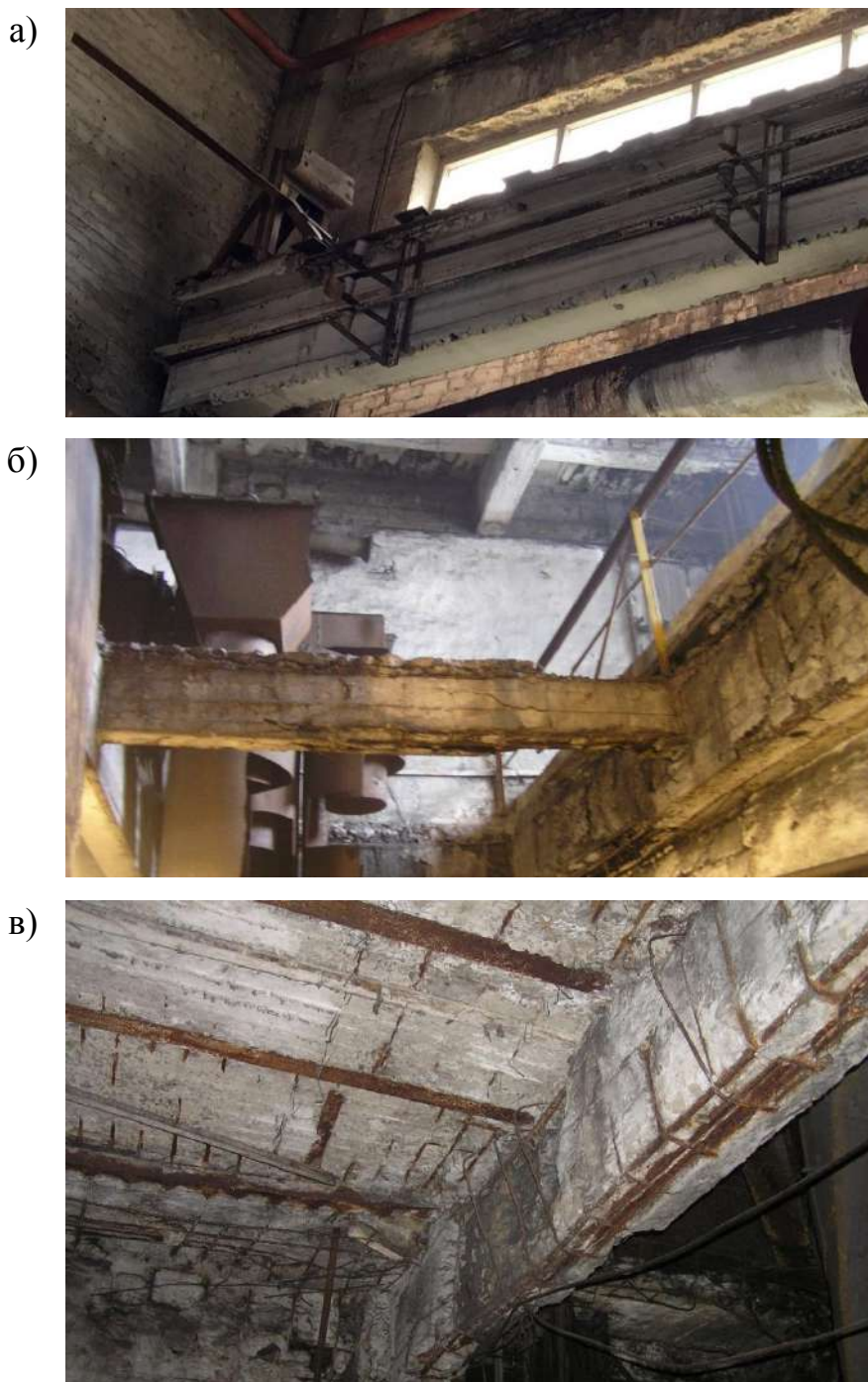
Рис.1.6. Пошкоджені залізобетонні балки: а) – підкранова балка Слов`янського машинобудівного заводу; б) – монолітна балка перекриття Добропільської ЦЗФ; в) – балка монолітного ребристого перекриття Добропільської ЦЗФ
