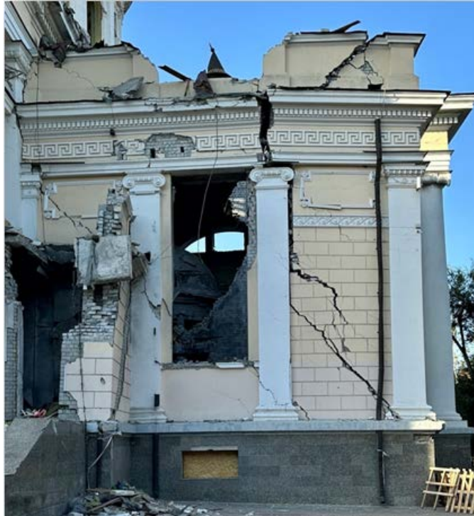
Рис. 1. Пошкодження будівлі Спасо-Преображенського кафедрального Собору внаслідок ракетного обстрілу (фасад в осях 12-14)
