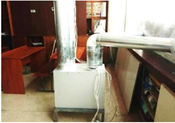
Рис. 5.11 Блок з вентагрегатами та рекуператором
