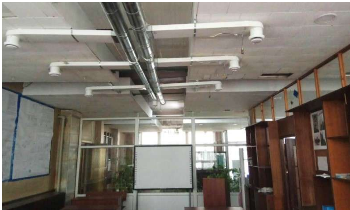
Рис. 5.10. Припливна-витяжна система вентиляції з рекуператором та інтелектуальною системою управління
