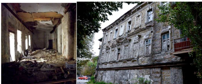
Рис.2 Состояние внутренних конструкций и боковой фасад
