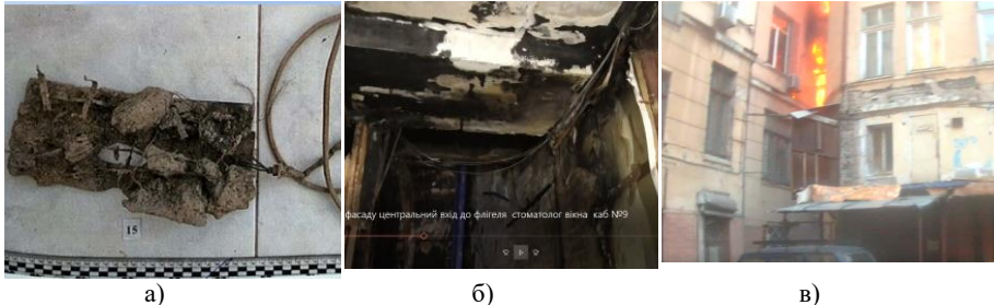
Рис.1. Наслідки аварійного режиму роботи електричного подовжувача: а) джерело запалювання - аварійний подовжувач зі слідами перенавантаження електромережі; б) під стелею спостерігаються провідники аварійної електричної мережі; в) на сходовій клітині спостерігається інтенсивне горіння від термічної дії електричної енергії перенавантаженої електромережі провідників
