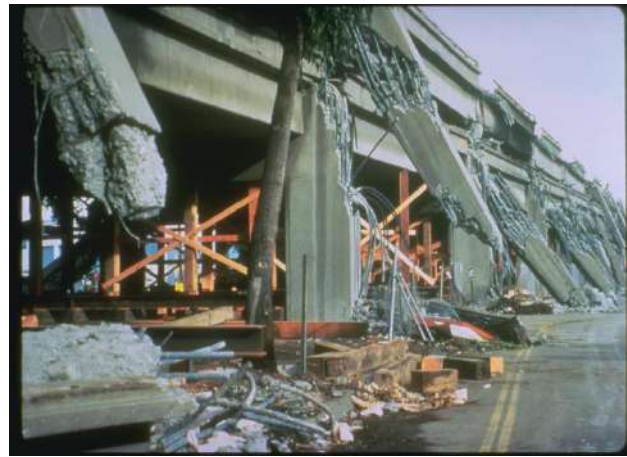
Фото 2. Руйнування каркасної будівлі по крайніх несучих колонах від сейсмічного впливу (приклад 2)
