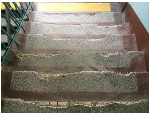
Рис. 5. Механические повреждения лестницы.
