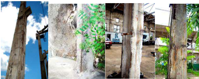
Рис. 1. Приклади пошкодження залізобетонних стиснутих двотаврових конструкцій.
