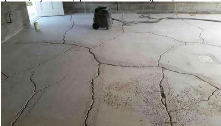
Рис. 2. Механические повреждения пола.
