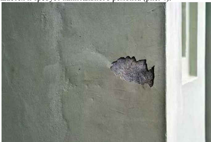
Рис. 3. Отслоение штукатурки на перегородке.
